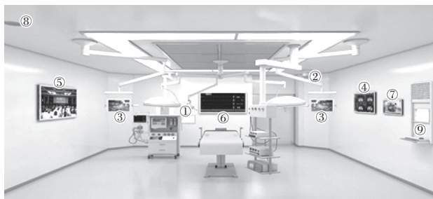
① 术野摄像机; ② 全景摄像机; ③ 全景显示屏; ④ PACS屏; ⑤ 多功能显示屏 ⑥ 监护仪显示屏; ⑦ 触摸控制屏; ⑧ 吸顶喇叭; ⑨ 护士工作站。
